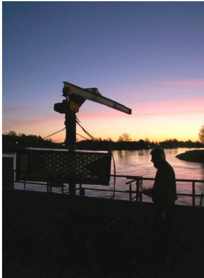
Tinorna gjorda av hålstansade stålplåtar. Kedjorna på kranen rasslar när tinorna vinschas upp ur älven vid Ljusnefors kraftverk.
